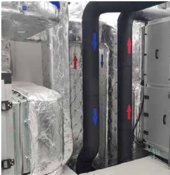
Fotografia 2.36. System rekuperacji hali w Ryczywole
