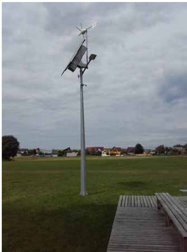
Fotografia 2.8. Widok na bezprzewodową stację meteorologiczną w Łuszczanowie
